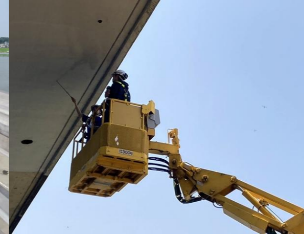
■橋の点検、見学会(協力:国土交通省九州地方整備局 宮崎河川国道事務所)
